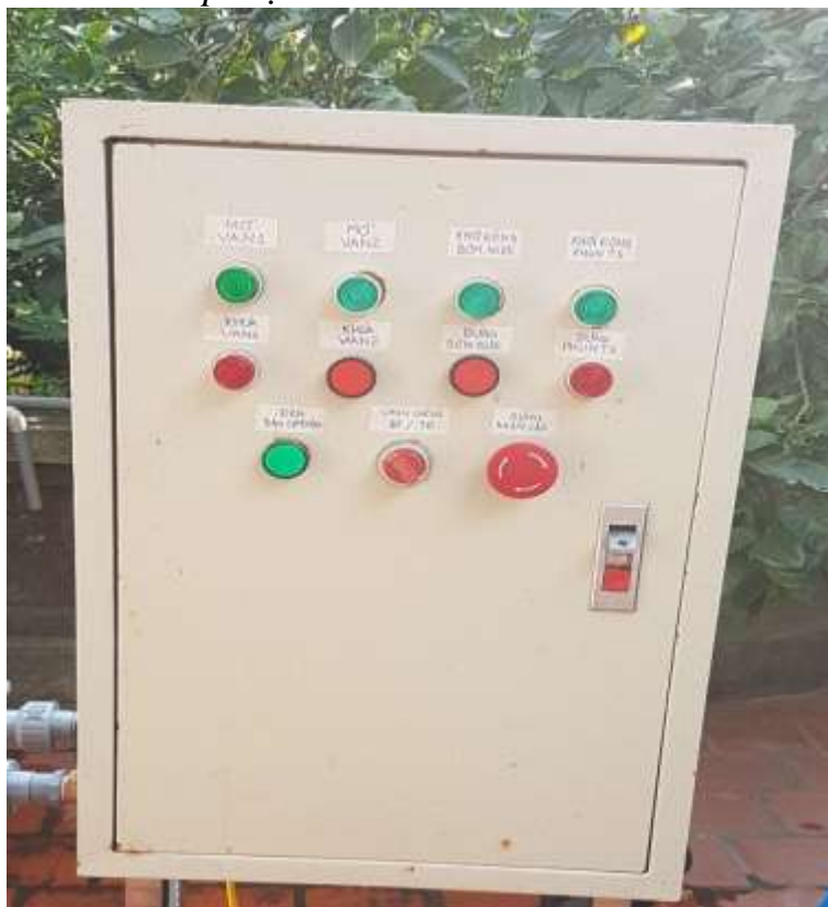
Cánh tủ điện
