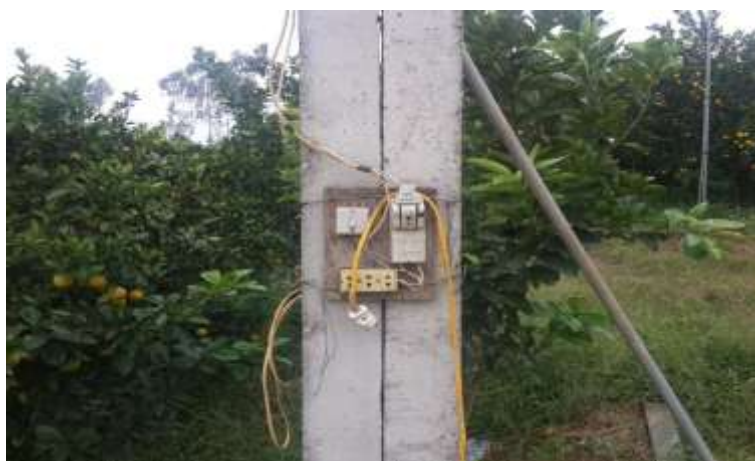
Hình 2.7: Hệ thống khởi động cấp điện cho hệ thống tưới bán tự động tại nhà vườn An Thái
