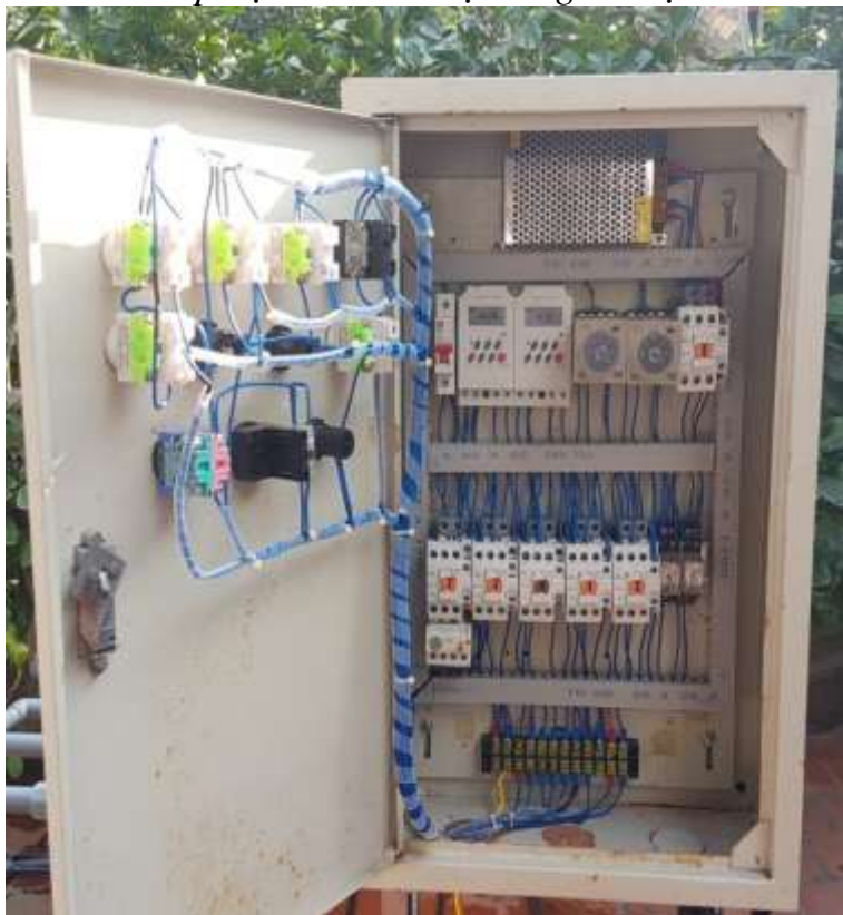
Tủ điện hoàn chỉnh
