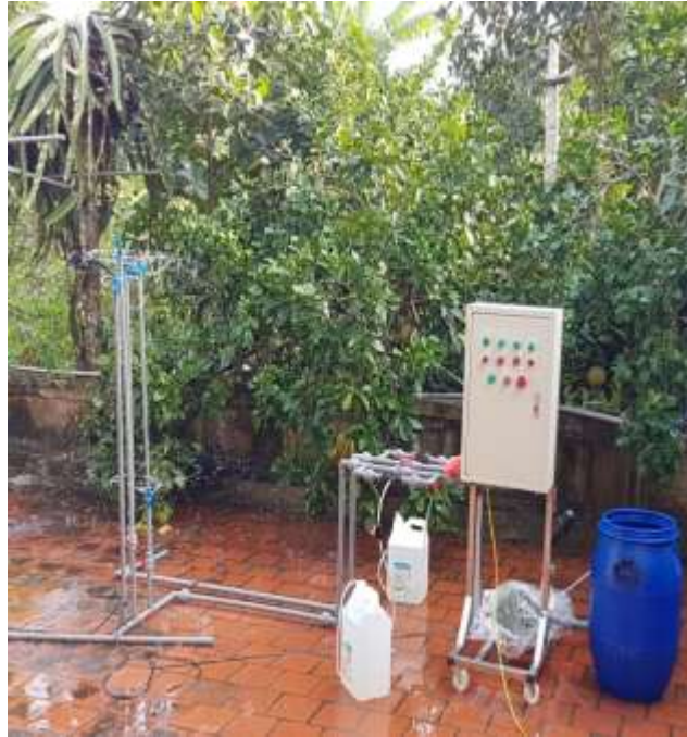
Hệ thống hoàn thiện
